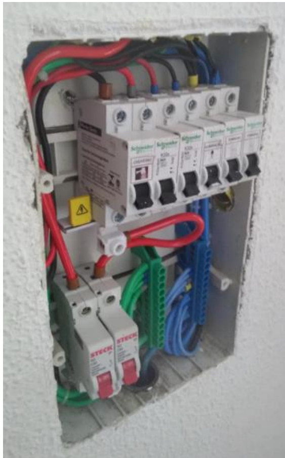
Figura 9: Quadro de Distribuição
